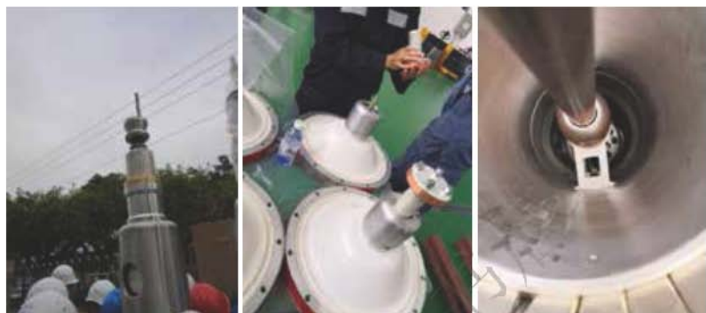
A相动触头侧导向环已脱落
