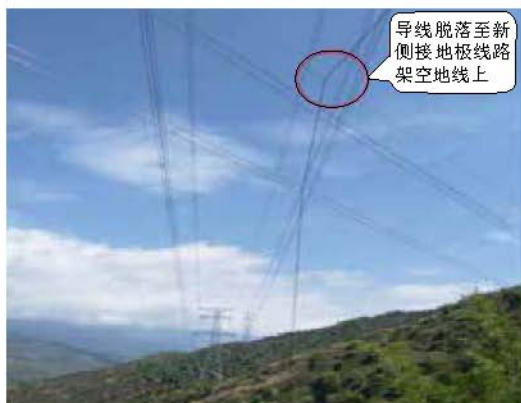
图3-6-4 导线脱落情况
