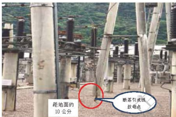
图3-6-2 110kV某变断落引流线
