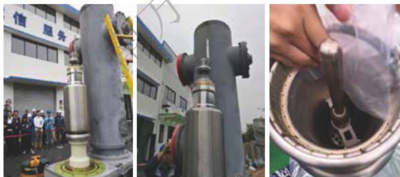
B相解体无明显异常
