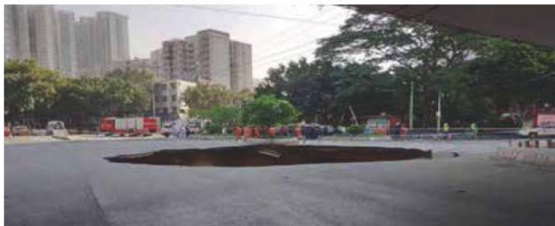
图3-6-8 故障位置塌方现场图
