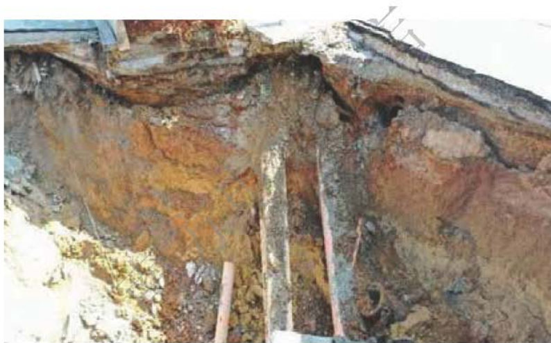
图3-6-9 故障位置受损光缆图
