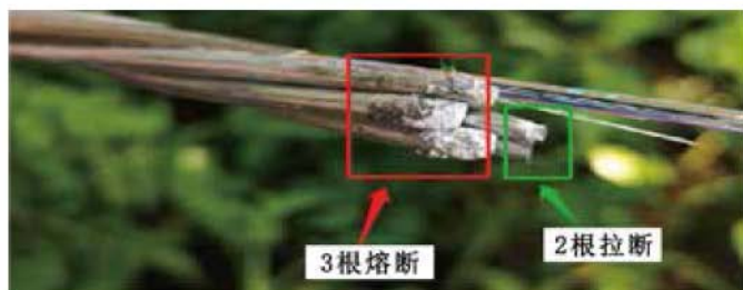
图3-7-7 内层6根，3根断口处熔断痕迹明显，2根未拉断呈紧缩装
