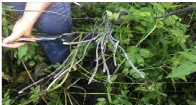
图3-7-8 500kV贺罗 I 线#449-#450光缆受损情况
