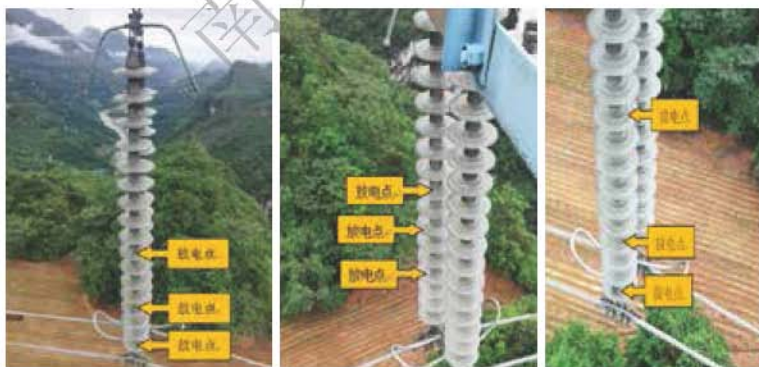
图3-7-5 220kV鹿马Ⅰ回#009号塔A、B、C相放电点
