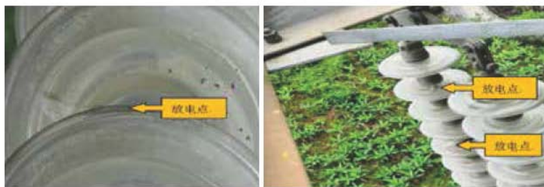
图3-7-6 220kV鹿马Ⅱ回#009号塔A、B相放电点
