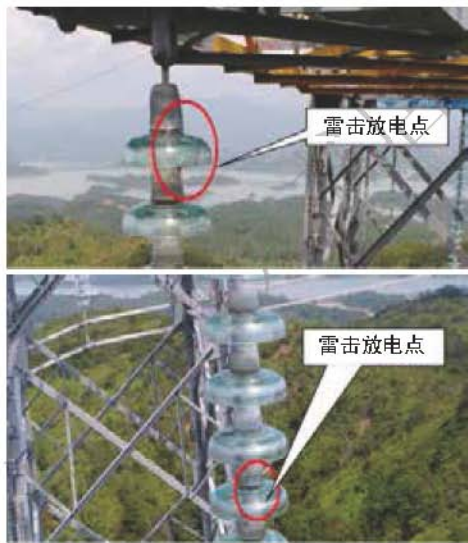
图3-5-3 500kV庐祯乙线N289塔C相雷击放电点
