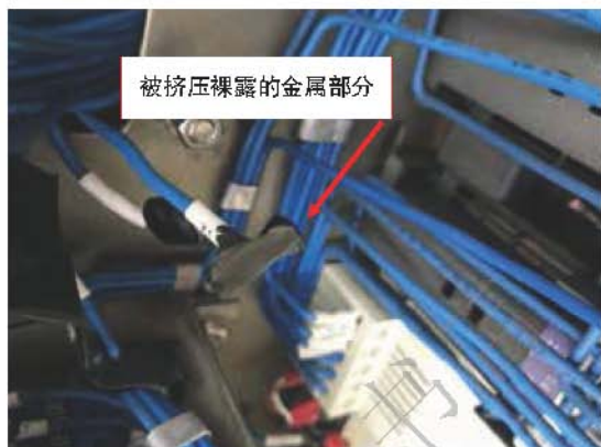
图3-7-3 现场电缆线芯和包扎裸露情况
