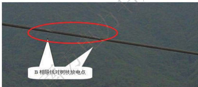
图3-7-4 220kV甘徐线#263-#264塔B相导线放电痕迹
