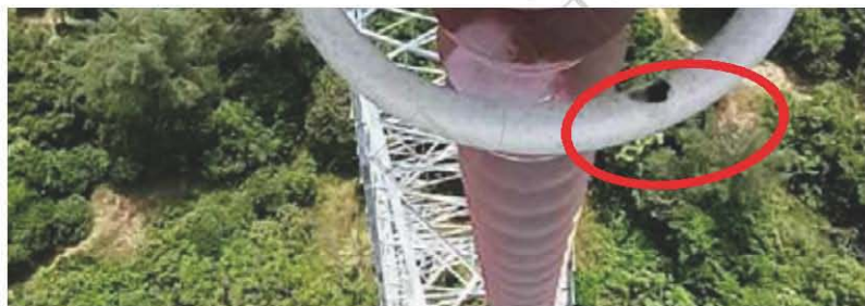
图3-7-11 220kV迈牵I线#N2塔C相绝缘子和均压环雷击痕迹
