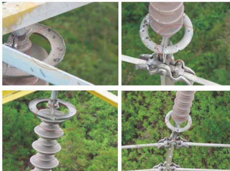
图3-5-4 故障绝缘子上均压环放电痕迹照片
